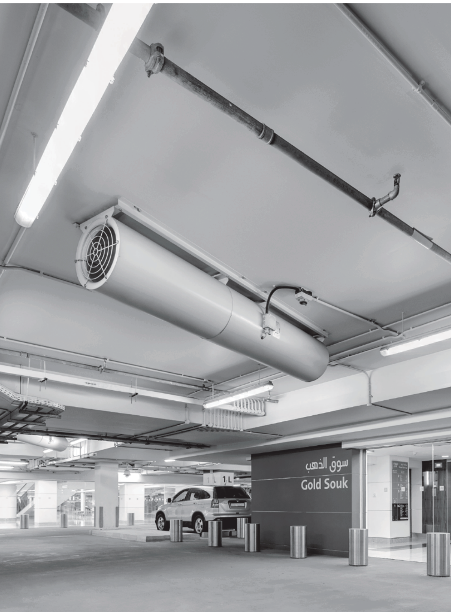
Dubai Mall w Dubaju, System wentylacji strumieniowej Systemair
